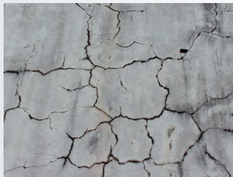
Typische Netzrisbildung an Beton, der durch AKR geschädigt ist.
